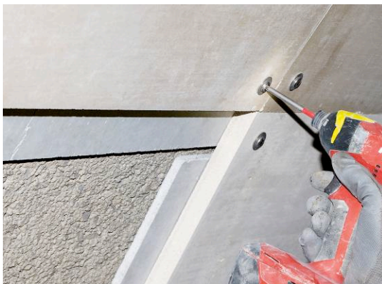
HECO_réf_internationale_Autriche_tunnel_Vorarlberg_renfort.jpg Avant le montage, les plaques coupe-feu sont munies de bandes de renfort de 10 mm.
