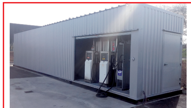
Hectronic pour les Ets STAV (Quimper - 29) Vue latérale droite de la cuve
