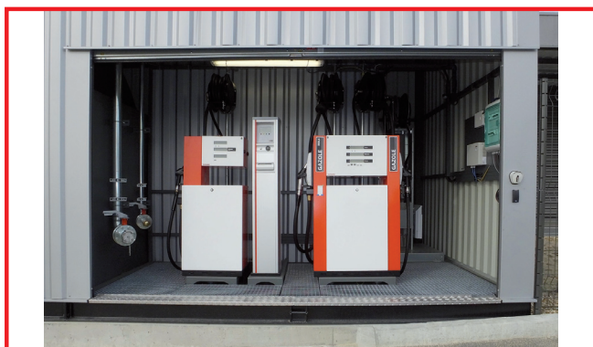
HECTRONIC pour les Ets NAULET (Baugé - 49) 1 Hecdistrib double + Simple + borne gestion Heconomy
