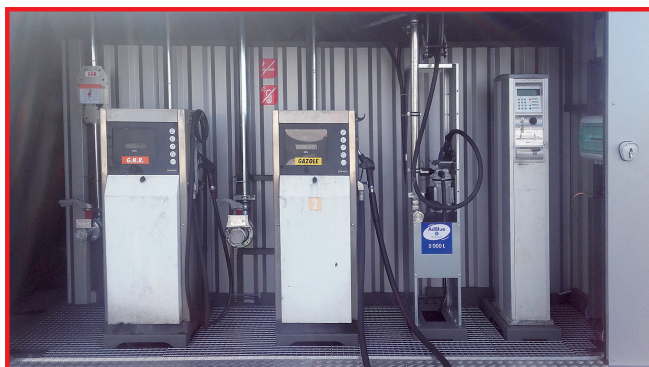
Hectronic pour les Ets STAV (Quimper - 29) 2 EUROS 1000 GO/GNR + AdBlue + Borne gestion TA2331
