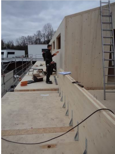
HECO-Réf_Rosenheim_construction étage.jpg 360 m 2 sur deux étages – la construction mince permet d'obtenir une grande surface habitable.
